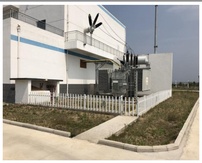
升压站内绿化
